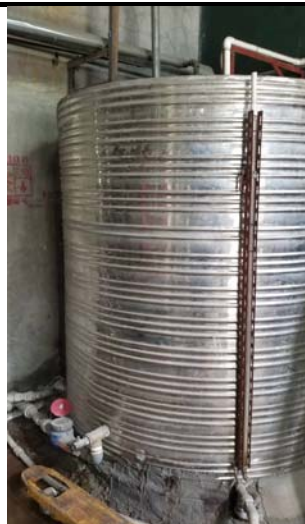
废弃锅炉水箱
