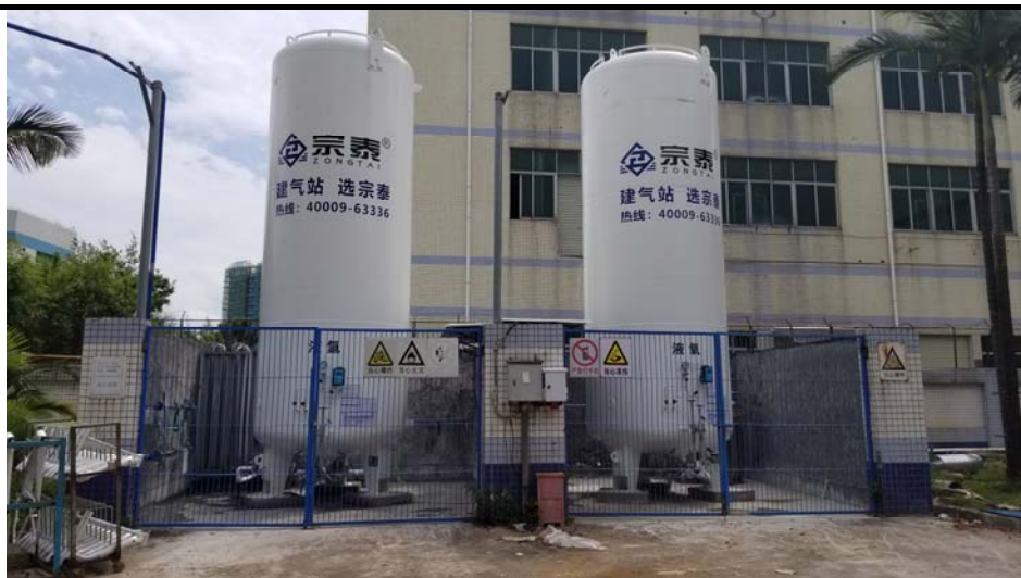
液氩、液氧储罐
