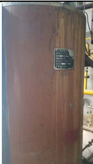
废弃蒸汽锅炉
